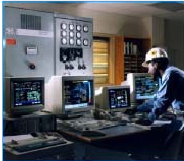
Fig. 2.15 Etapa de análisis y decisión sobre la condición de los equipos de planta
